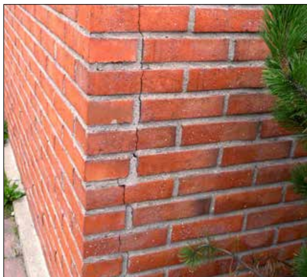
Exempel på tegelskalmur som växer över hörnen pga att liggfogarna utgör långa tryckstänger.
