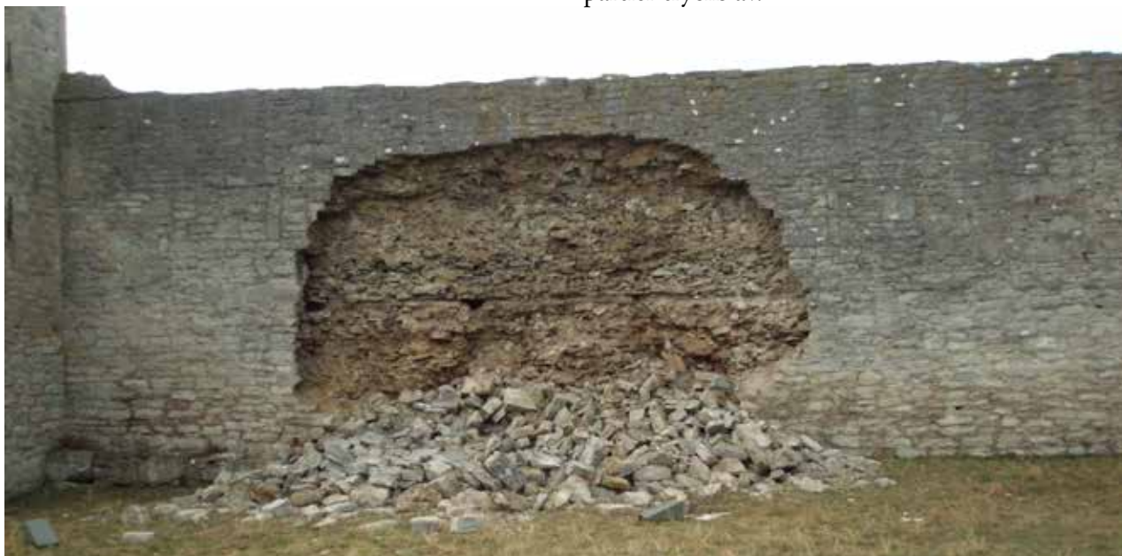
Exempel på mur som omfogats med sandrikt oelastiskt bruk.
