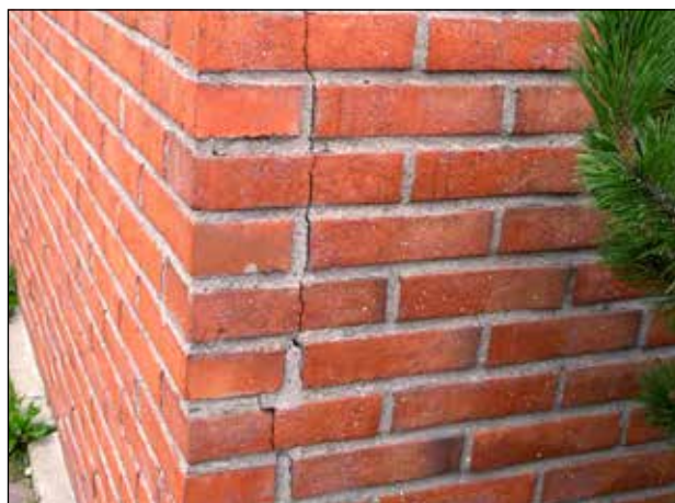
Exempel på tegelskalmur som växer över hörnen pga att liggfogarna utgör långa tryckstänger.
